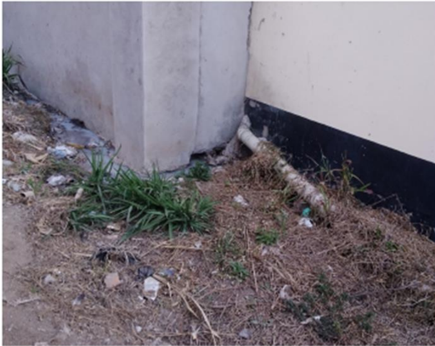
Toilet Soak way
